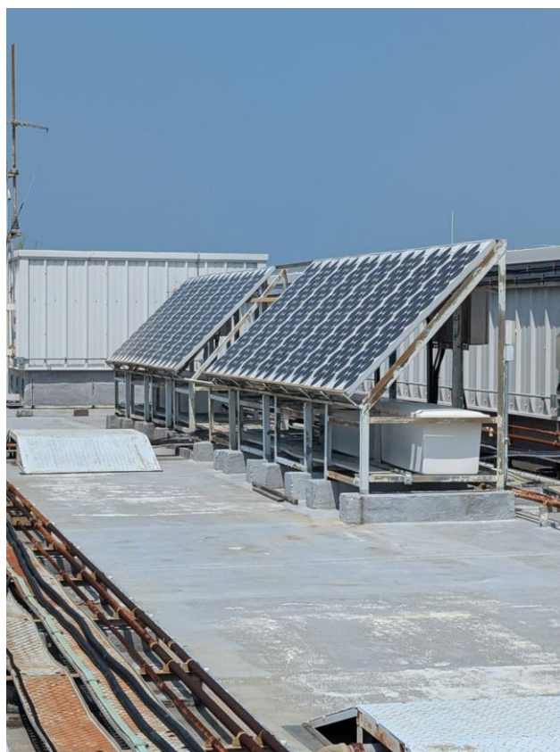
政府飛行服務總部天台的光伏發電系統
